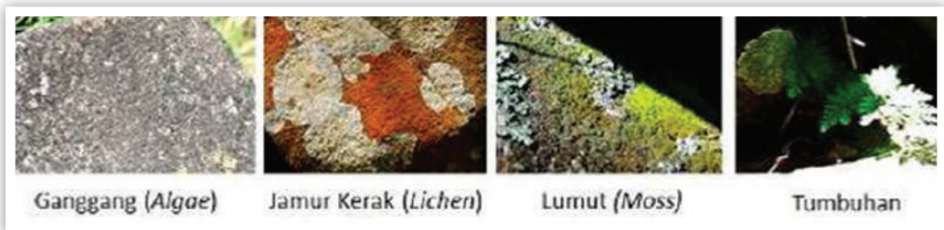
Foto 5.5 Beberapa bentuk kerusakan yang disebabkan oleh faktor biotis di batuan dan susunan balok batu situs Gunung Padang. (Yondri, dkk., 2012)
